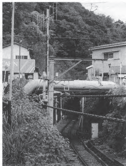
極楽寺駅側のトンネル入口に取付けられたアンテナは、LCXと電波をやりとりする窓口になっている。
