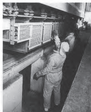
検車区のピット内は、下回りの点検がしやすいように、下に穴が掘られた構造になっている。
